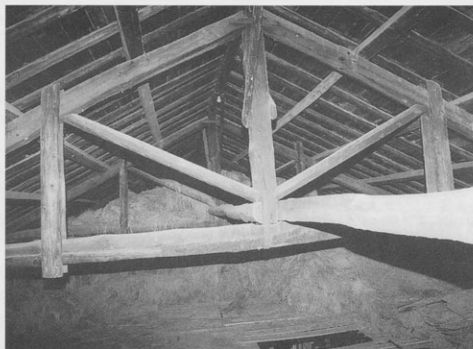
Nun entdeckte Teiles des Gebälks einer der ehemaligen Baracken.
